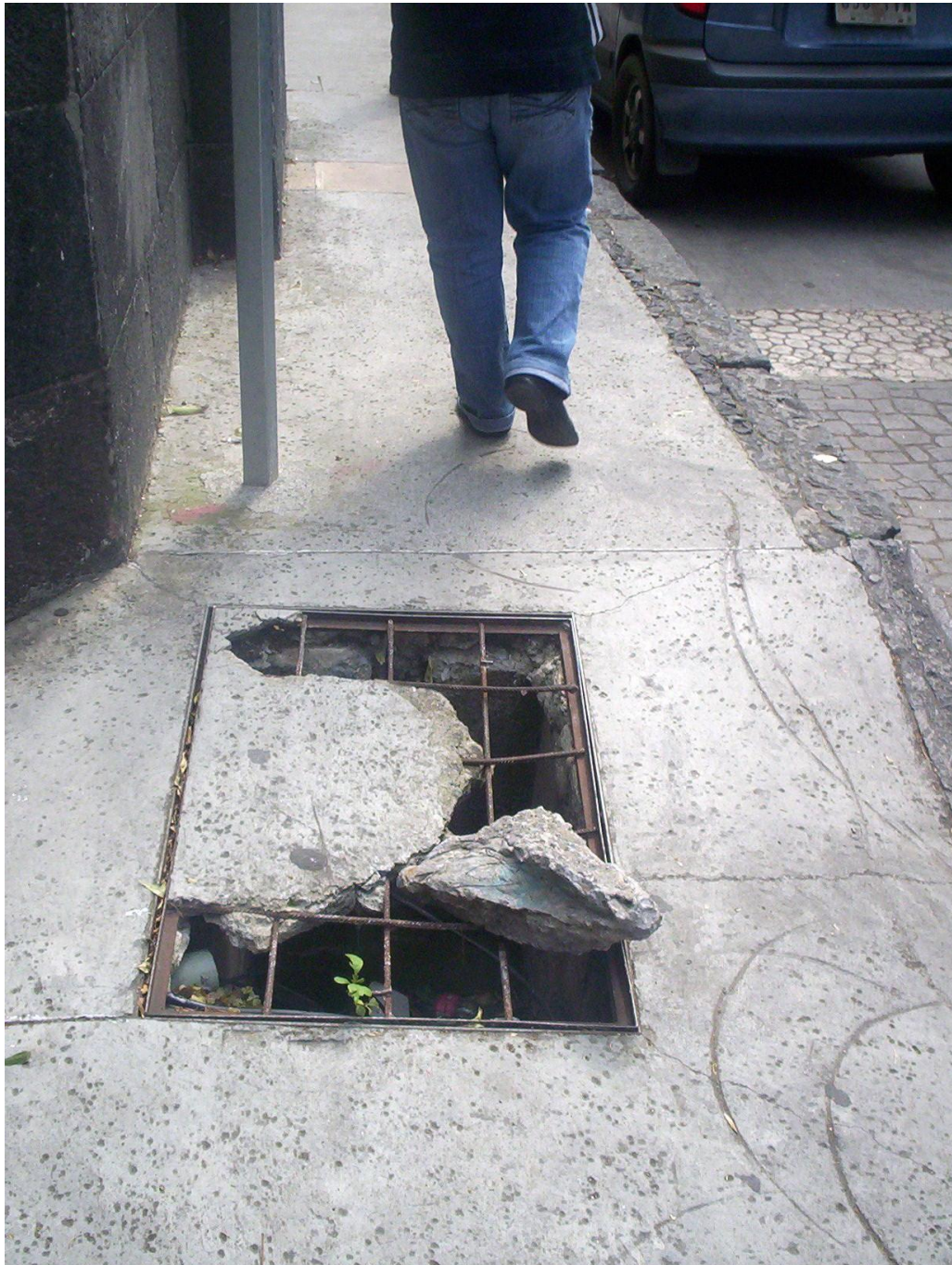
Ilustración 25: Rampa con coladera rota que es un peligro para cualquier transeúnte. Foto: Mariana Hernández Flores, octubre de 2009.
