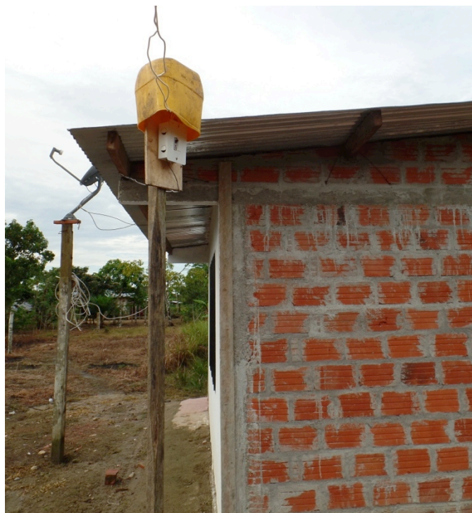
Figura 11. Instalación eléctrica de una casa de Nuevo Amanecer. Nótese detrás la antena de televisión satelital. Fuente: fotografía tomada por la autora, 2014.
